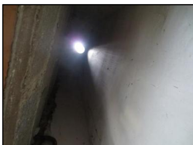
Photo N° 1048 AMIANTE CIMENT -- PLACARDS TECHNIQUES +3 Plafonds Ventilation haute (Fibres- ciment)
